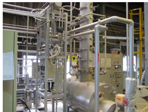
バイオエタノールプラント
